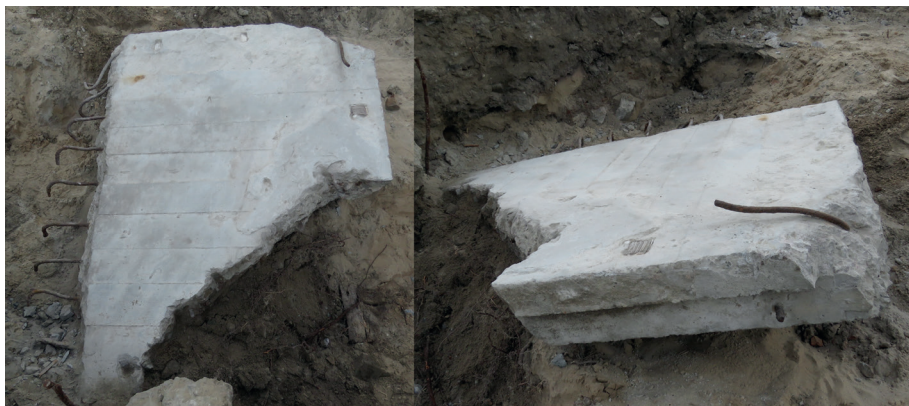
Ryc. 21. Dwa ujęcia południowego fragmentu ściany zachodniej górnej kondygnacji wartowni nr 5, odnalezionego w zasypisku leja po bombie SC 50, która eksplodowała 2 września 1939 r. przy narożniku południowo-zachodnim budynku. Zwracają uwagę odkształcone pręty zbrojenia narożnika ściany (zdjęcie po lewej) oraz miejsce do osadzenia ościeżnicy drzwi wejściowych do górnej kondygnacji (zdjęcie po prawej). Na fotografiach widoczne lico wewnętrzne ściany (źródło: MIIWŚ)
