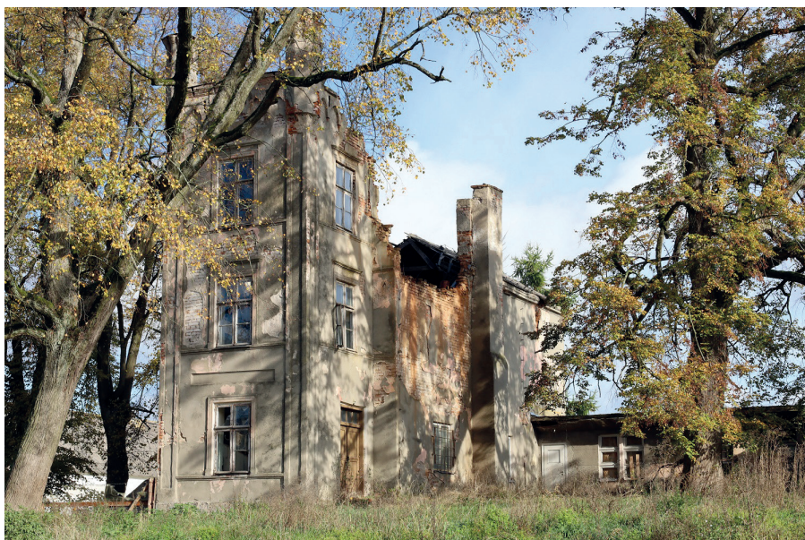
Ryc. 176. Popadający w ruinę budynek dworu w Stawku (pow. mrągowski)
