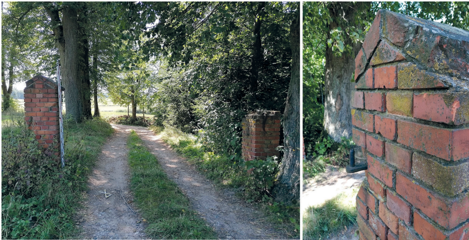
Ryc. 114. Murowane filary wjazdu bramnego w dawnej kolonii Johannistal (pow. giżycki, gm. Krukłanki)
