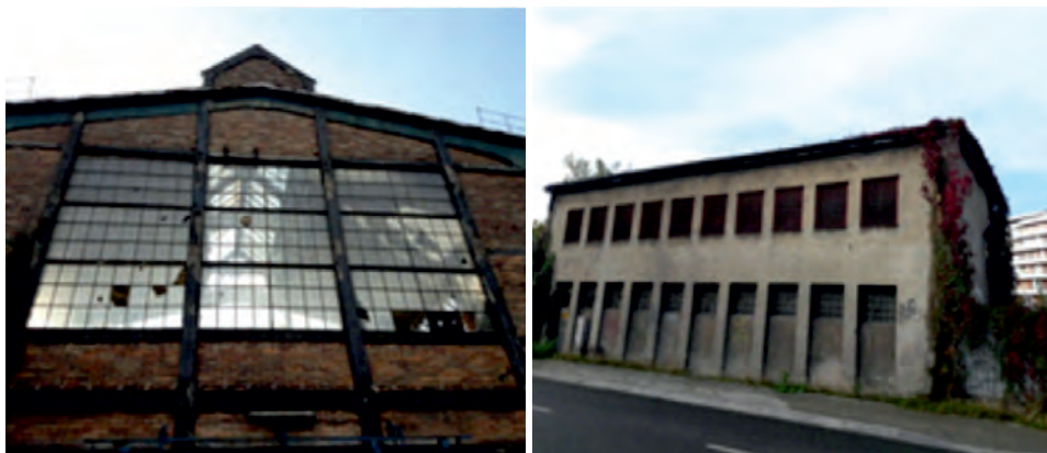
Fot. 21. Ruiny hali maszyn Zakładów Zieleniewskiego i ostatni ocalały nadal eksploatowany budynek (przeznaczony do rozbiórki) (stan październik 2020)
